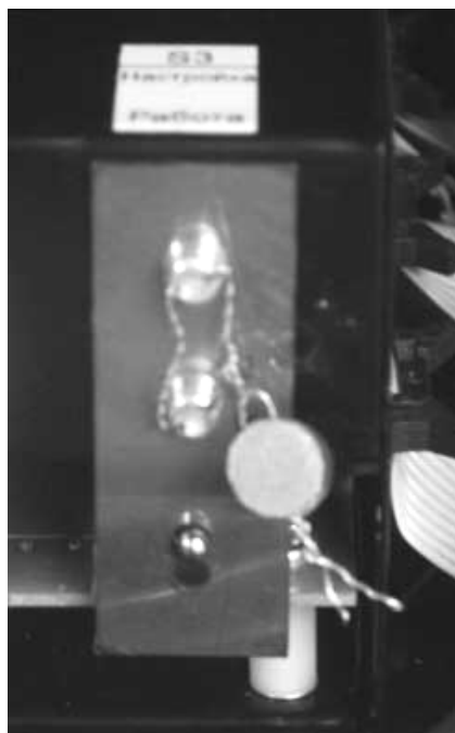
Рис.3. Пломбировка тумблера «Настройка/Работа» блока управления
